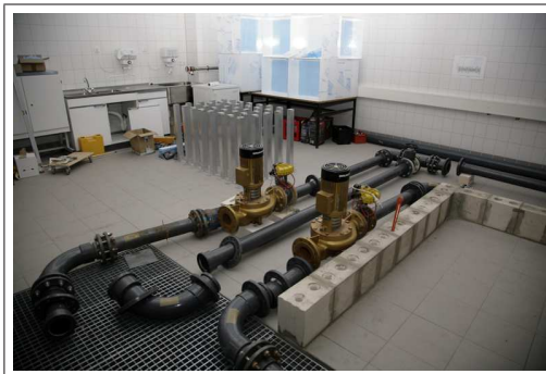
(a) Anschluss der Pumpeneinheiten
