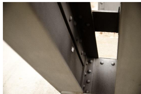
Abbildung 13: Kriegsschaden an der alten Rethehubbrücke
