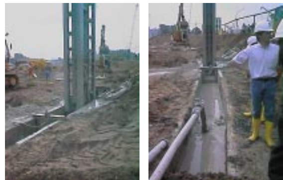
Abb. 2 und 3: Schlitzwandbagger beim Aushub und bei der Verfüllung des Schlitzes mit Bentonitsuspension
